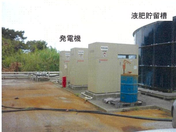
写真10 バイオガスプラントの液肥貯留槽、発電機
