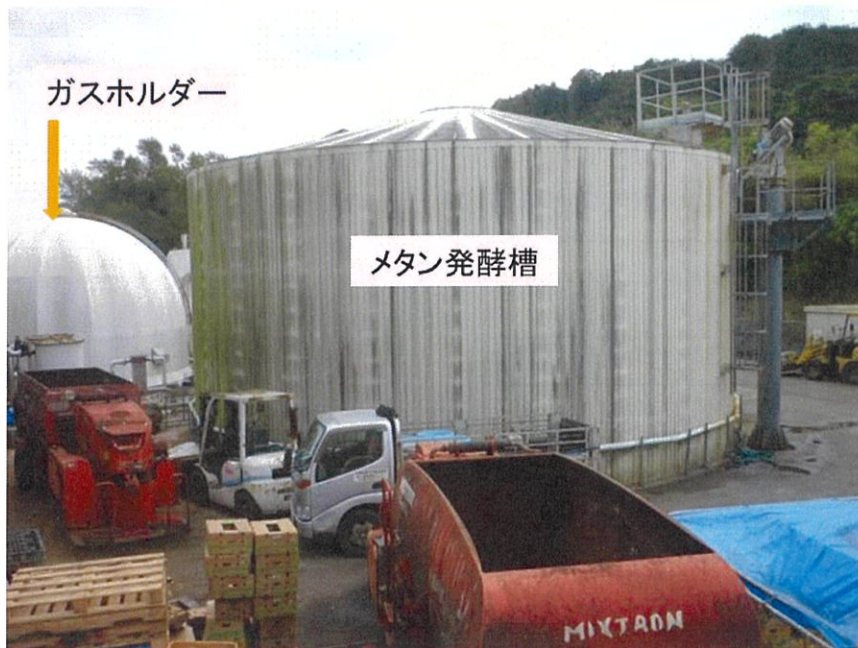
写真9 バイオガスプラントのメタン発酵槽、ガスホルダー
