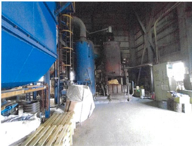
写真 11 廃プラ利用ボイラ
