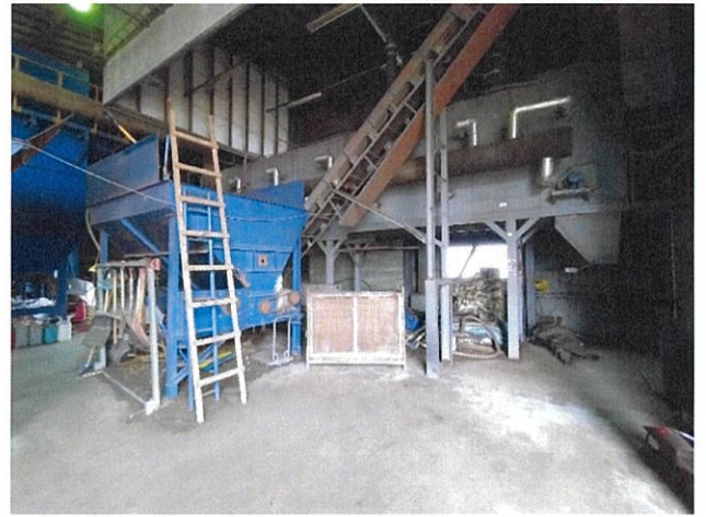
写真 12 故障した乾燥機
