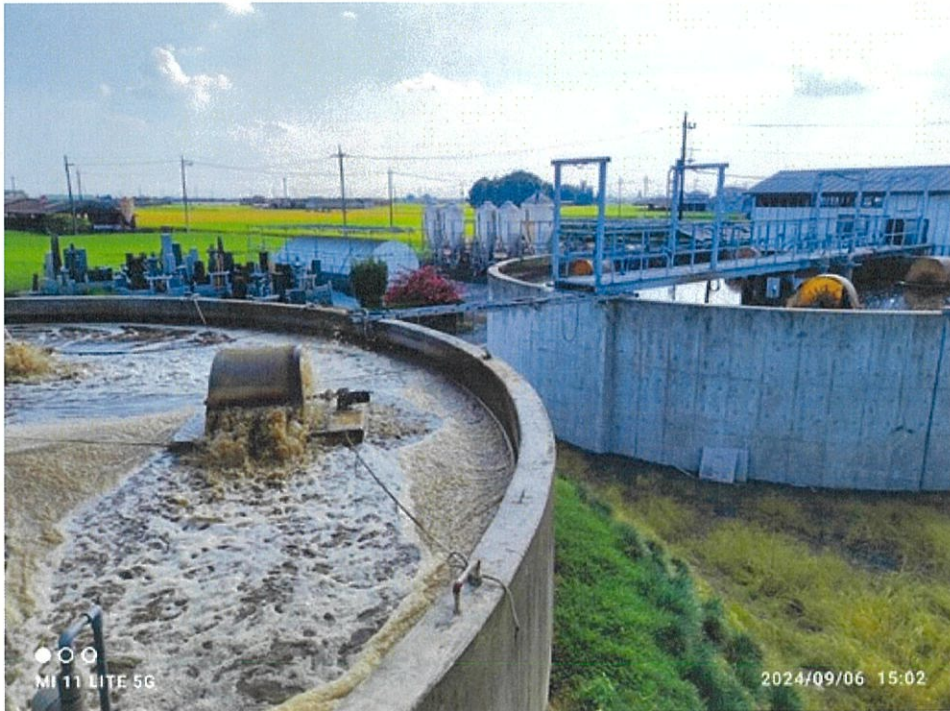
写真 10 浄化槽(活性汚泥浄化処理施設)
