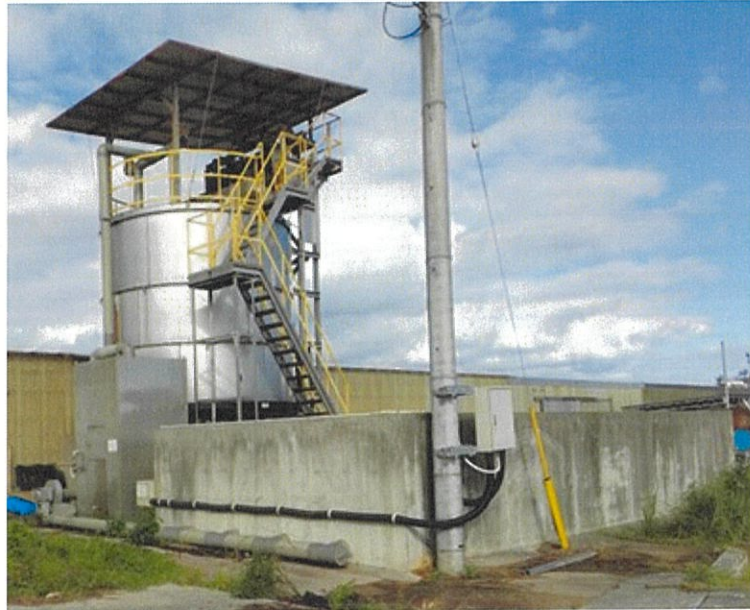
写真3 縦型コンボ(手前は脱臭設備)
