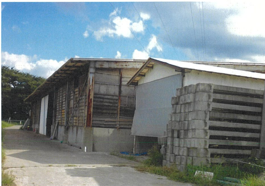
写真5 悪臭が拡散しないように開口部が塞がれた堆肥舎
