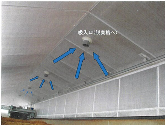
写真3 発酵槽内換気装置
