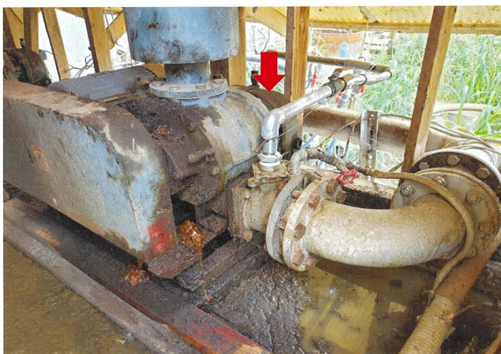
写真 12 家畜用浄化処理施設の曝気用ブロワから下部通気に分岐した配管の様子
